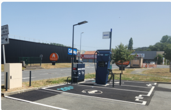
Bornes de recharges électriques sur l'actif de Périgueux.
